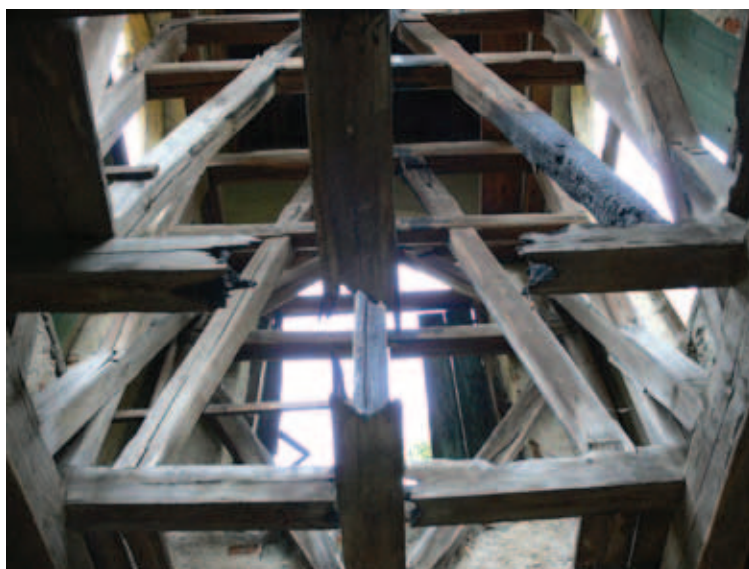
Obr. 7 Drevená konštrukcia krovu na katolíckom cintoríne. Prednom poškodená vandalmi. (Foto E. Kráľová)
