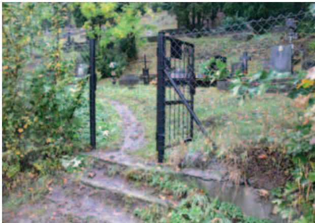
Obr. 12 Zeminou prisýpané schodíky pri vstupe do cintorína vytvárajú nebezpečnú naklonenú rovinu, z ktorej sa vo vlhkom počasi stáva neželaná šmýkačka. (Foto E. Kráľová)
