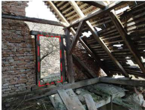
Dvorové krídlo- vstup do podkrovia nachádzajúci sa v rámci SZ štítu krídla -havarijný stav
