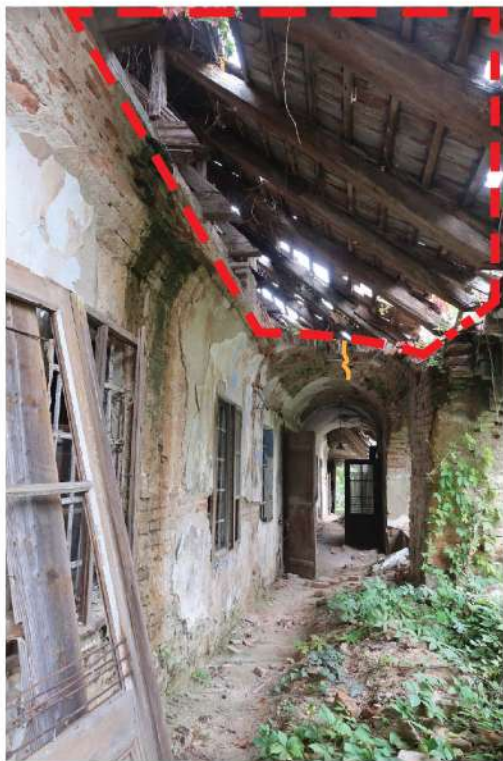
Čiastočne spadnutá klenba arkádovej chodby uličného krídla (m.č. 1.10)
