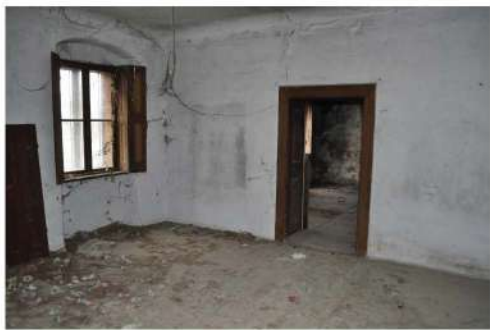
Poškodenie drevených parkiet. Sekundárne prekrytie linoleom (m.č. 1.06)
