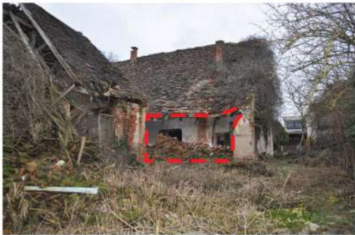
Pohľad na zrútenú stenu arkádovej chodby (m.č. 1.11)
