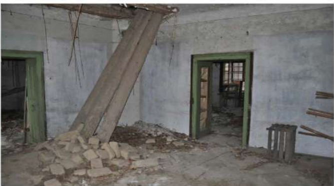
Zrútený strop s drevokaznou hubou (m.č. 1.02)
