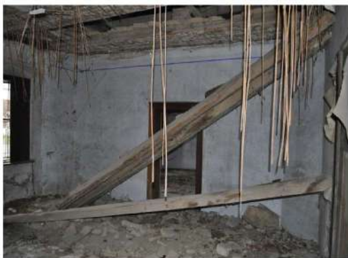
Zrútený povalový strop (m.č. 1.04)
