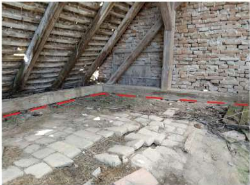
Rozsiahle poškodená podlaha z nepálených tehál
