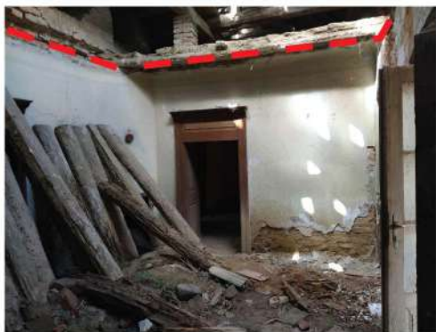
Zrútený povalový strop (m.č. 1.05)
