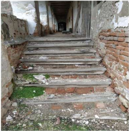
Úbytok pôvodnej hmoty schodiska
