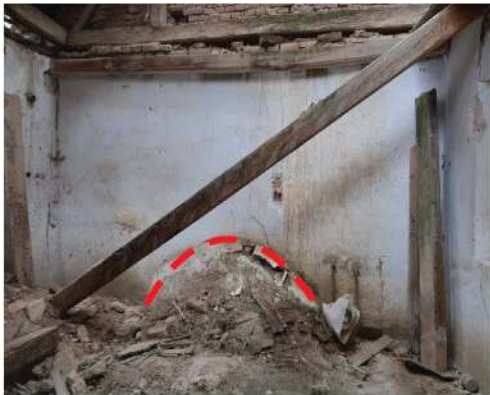
Prepadnutý trámový strop, konštrukcia klenby schodiska suterénu (m.č. 1.18)
