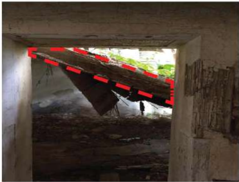
Prepadnutý trámový strop v dôsledku uhnitia záhlaví trámov (m.č. 1.13)
