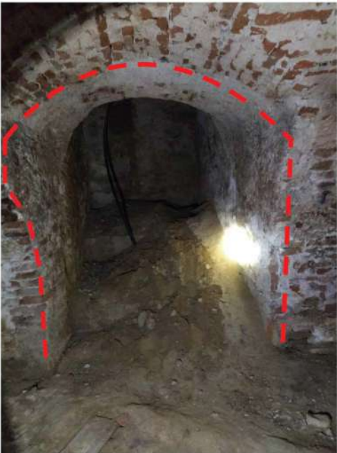
Valená klenba zaniknutého vstupu do pivnice lokálne úbytky pôvodnej omietkovej hmoty (m.č. 1.02)
