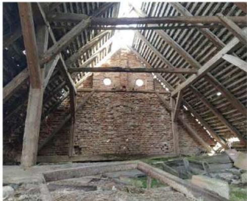
Dvorové krídlo- poškodený hrebeň strechy
