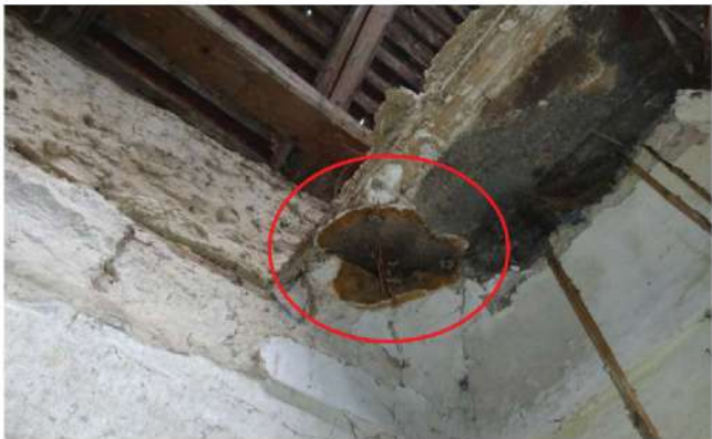
Krov oboch krídel objektu je napadnutý drevokaznou hubou
