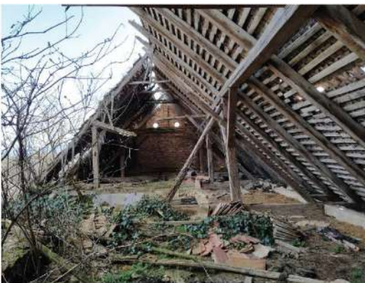
Dvorové krídlo- havarijný stav krovu
