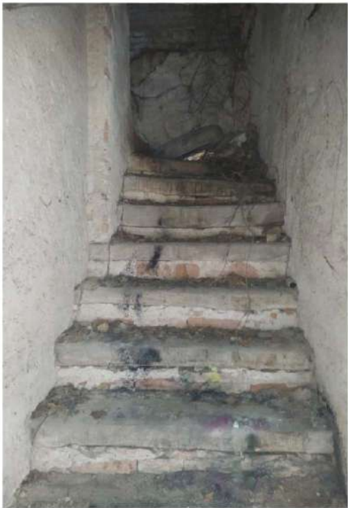
Poškodené schodisko vedúce do podkrovia s prepadnutou valenou klenbou uličnej časti
