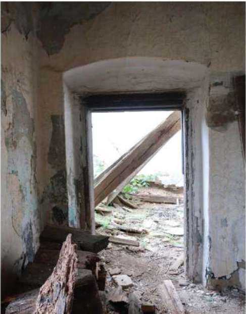
Prepadnutý trámový strop v dôsledku uhnitia záhlaví trámov (m.č. 1.16)
