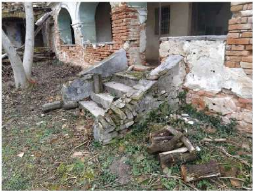
Úbytok pôvodnej hmoty schodiska
