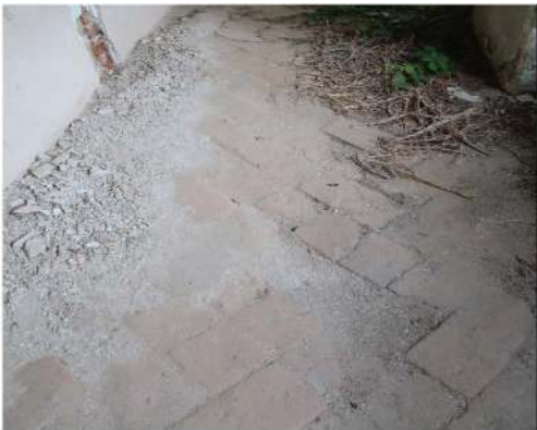
Poškodenie dlaždíc terakotovej podlahy, sekundárne betónové opravy a potery (arkádová chodba)
