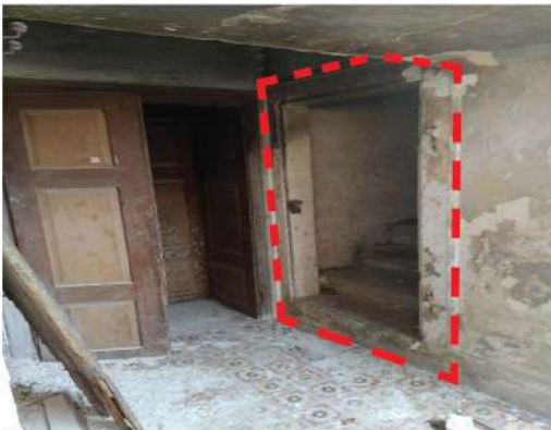
Lokálne úbytky pôvodnej kamennej hmoty portálu (m.č. 1.09)
