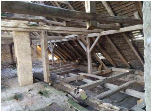
Uličné krídlo- zavlhnuté časti krovu a poškodená podlaha
