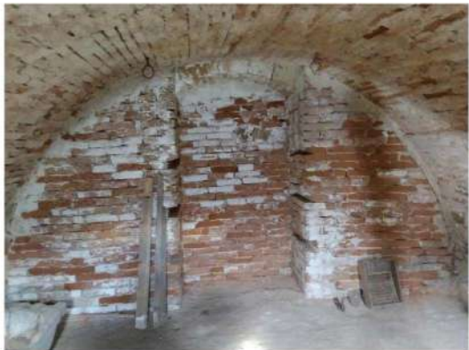
Lokálne úbytky a poškodenie pôvodnej hmoty (m.č. 01.04)
