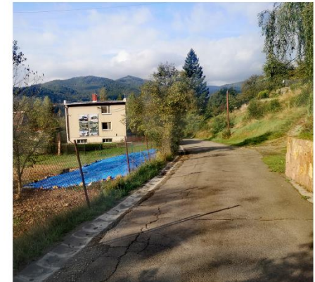
ZLÝ STAV CESTNEJ KOMUNIKÁCIE
