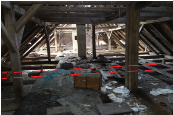
Uličné krídlo- poškodené väzné trámy vlhkosťou
