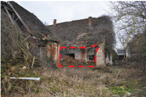
Pohľad na zrútenú stenu arkádovej chodby (m.č. 1.11)
