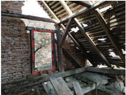
Dvorové krídlo- vstup do podkrovia nachádzajúci sa v rámci SZ štítu krídla -havarijný stav
