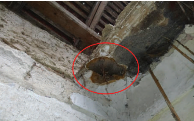
Krov oboch krídiel objektu je napadnutý drevokaznou hubou
