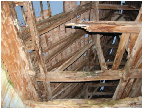
Uličné krídlo- Hnilobou silno poškodené až zničené prvky, chýbajúca krytina -havarijný stav
