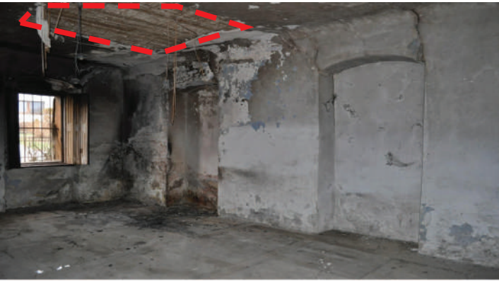
Zničená omietka stropu a obhorená časť steny (m.č. 1.08)
