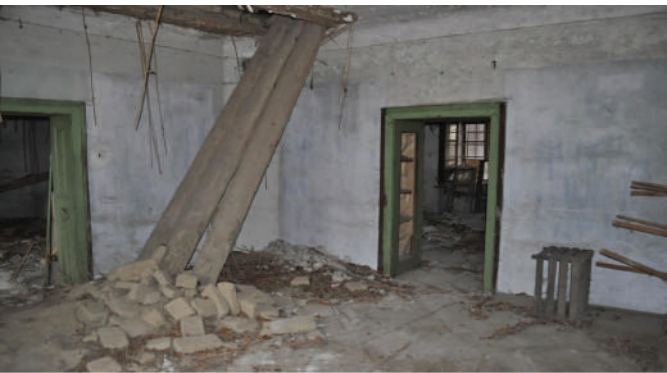
Zrútený strop s drevokaznou hubou (m.č. 1.02)
