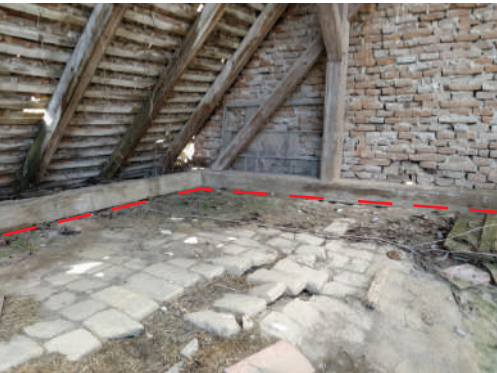
Rozsiahle poškodená podlaha z nepálených tehál
