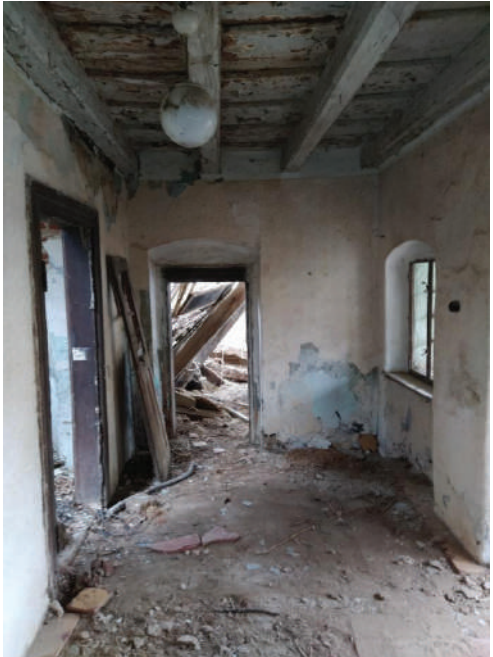
Zavlhnutý trámový strop (m.č. 1.15)
