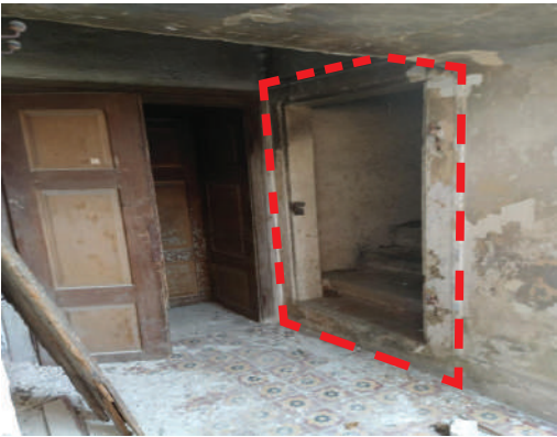
Lokálne úbytky pôvodnej kamennej hmoty portálu (m.č. 1.09)
