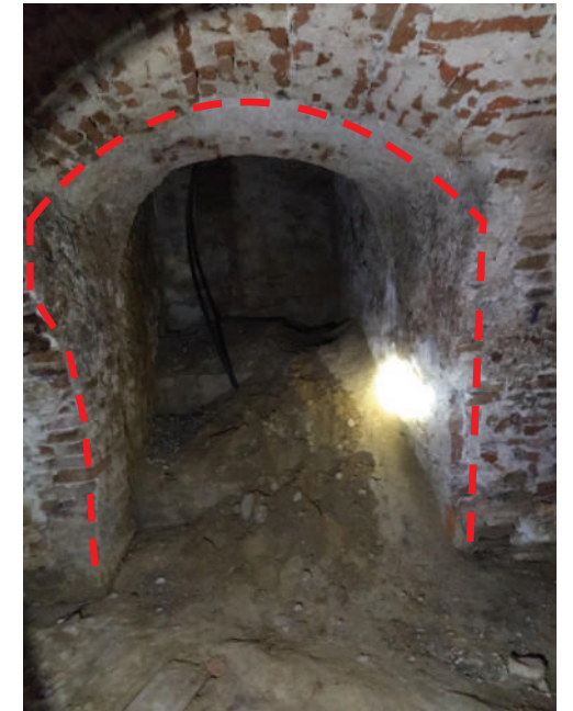
Valená klenba zaniknutého vstupu do pivnice lokálne úbytky pôvodnej omietkovej hmoty (m.č. 1.02)
