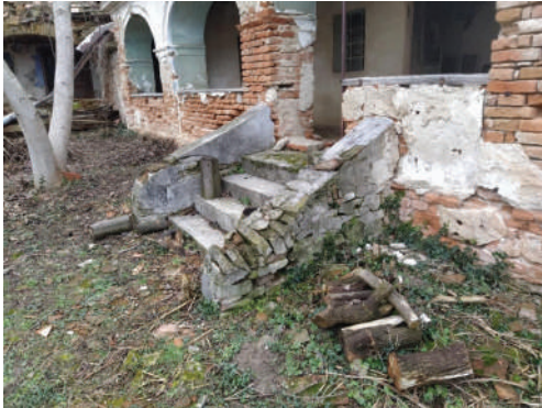
Úbytok pôvodnej hmoty schodiska
