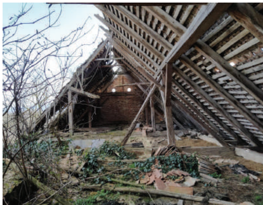
Dvorové krídlo- havarijný stav krovu
