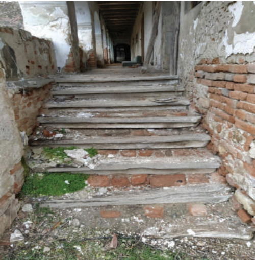
Úbytok pôvodnej hmoty schodiska
