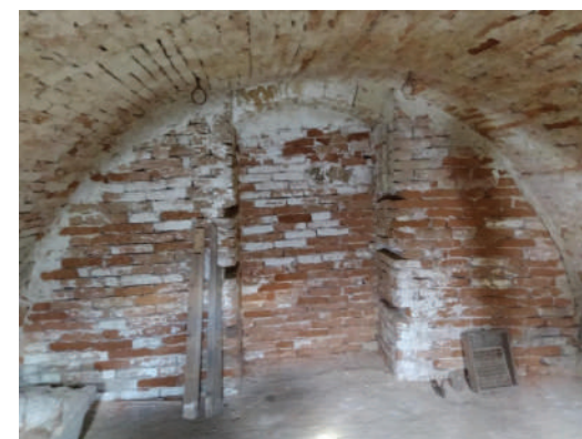
Lokálne úbytky a poškodenie pôvodnej hmoty (m.č. 01.04)
