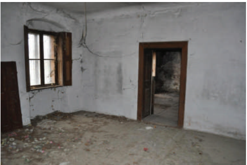
Poškodenie drevených parkiet. Sekundárne prekrytie linoleom (m.č. 1.06)
