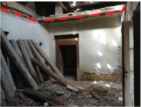
Zrútený povalový strop (m.č. 1.05)
