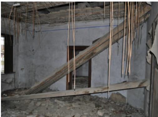
Zrútený povalový strop (m.č. 1.04)
