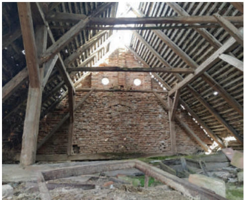
Dvorové krídlo- poškodený hrebeň strechy
