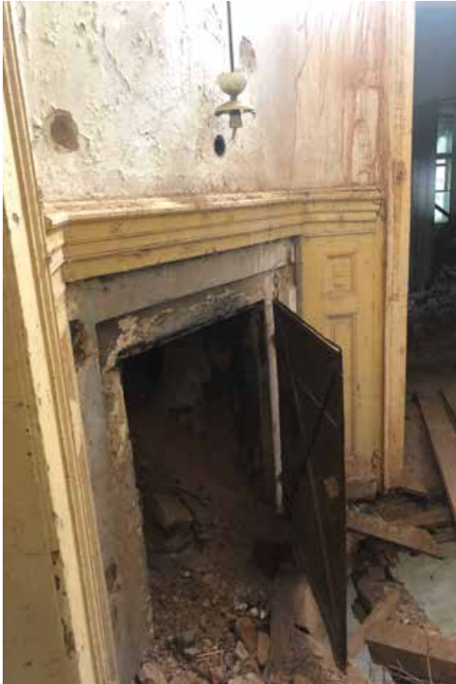
2NP_ PRIKLADACÍ OTVOR VYKUROVACÍCH TELIES [autorská fotografia]
