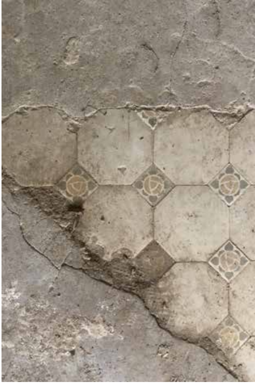
1NP_ ZACHOVANÉ FRAGMENTY DLAŽBY A DREVENÝCH PODLÁH [autorská fotografia]
