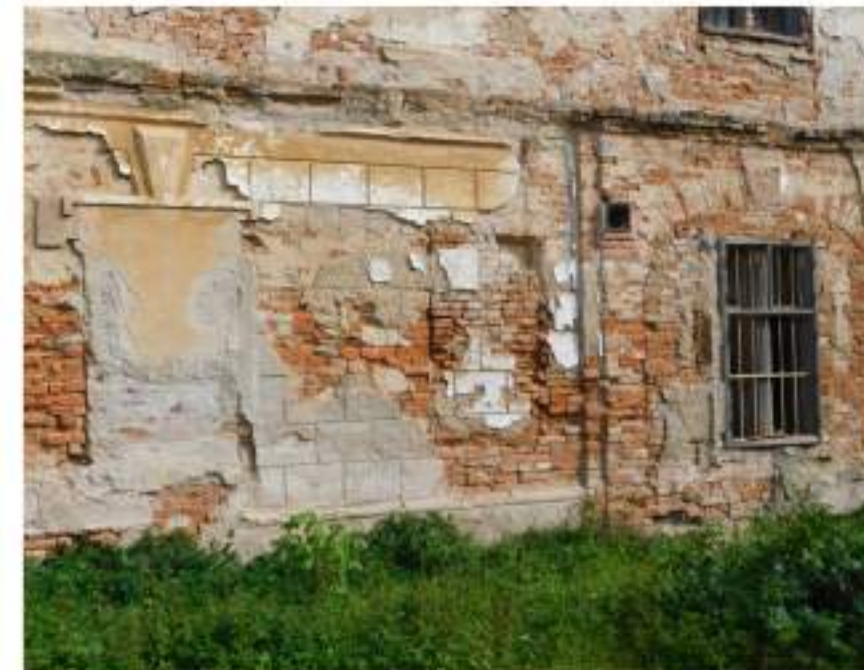
ZBYTKY ŠTUKOVEJ VÝZDOBY A ZAMUROVANÝ BAROKOVÝ PORTÁL (JUŽNÝ POHĽAD)
