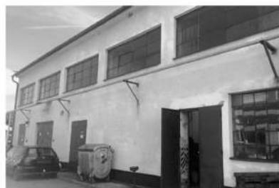
8. DIELNE III. Murovaná stavba, 1. polovica 20. stor. Povrchové poškodenie opotrebovaním. Možné zachovanie budovy.
