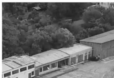
7. DIELNE II. Murovaná stavba, 1. polovica 20. stor. Chýbajúca dverná výplň. Poškodenie opotrebovaním. Možné odstránenie.
