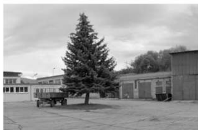
6. DIELNE Murovaná stavba, 2. polovica 20. stor. Poškodenie fasády opotrebovaním. Možné odstránenie budovy.
