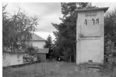
13. ELEKTROROZVODNA Murovaný objekt 1. polovica 20. stor. povrchové poškodenie. Zachovanie objektu, potrebné odstránenie vlhkosti.
