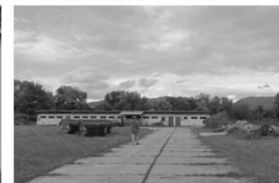
10. SKLADY Murovaná stavba, 1. polovica 20. stor. povrchové poškodenie opotrebovaním. Možné odstránenie budovy.
