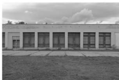
12. VÝROBNÁ HALA Murovaná stavba 1. polovica 20. stor. Povrchové poškodenie s nánosmi. Zachovanie budovy a potrebná úprava fasády.
