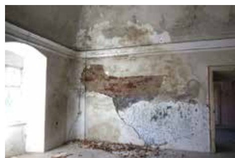
nevhodná úprava stien - zadržiavanie vlhkosti
