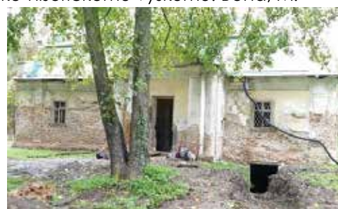
vstup do pivníc podkopané základy
