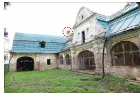
nevhodné cementové omietky poškodené komíny
