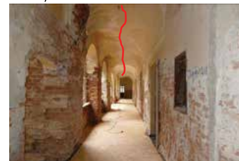
trhliny v arkádovej chodbe
