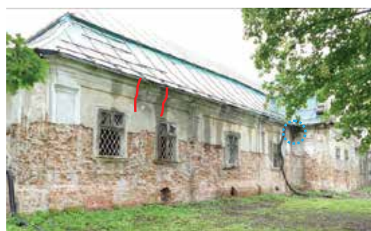
deformácia muriva nevhodne odvedená dažďová voda
