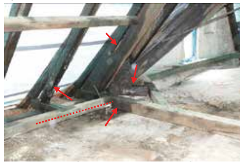
Poškodené prvky pri centrálnom dvor.štíte
