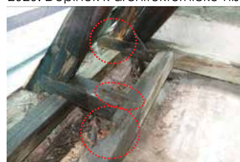
poškodené prvky pod vikierom
