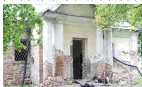
vzlínava vlhkosť porušenie muriva
