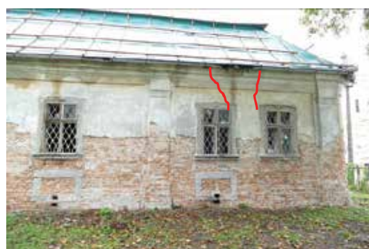
deformácia muriva zaslepenie vetracích otvorov pivníc
