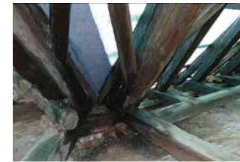
poškodené prvky východného kridla
