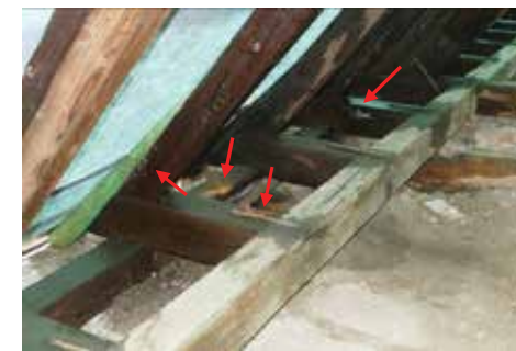
hubou a hnilobou poškodené prvky
