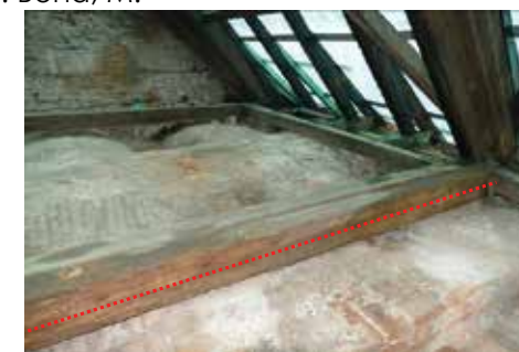
Vážný trám poškodený fúzačom krovo-vým
