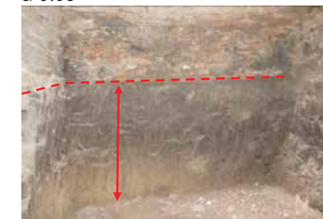
podkopaná základová škára
