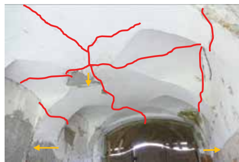
havarijný stav prejazdu v severnom krídle
