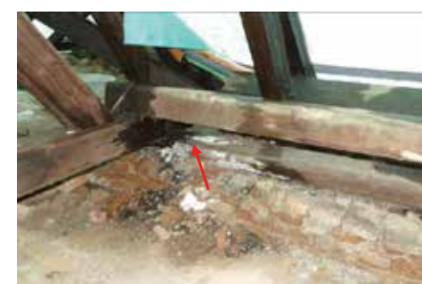
hubou poškodené prvky
