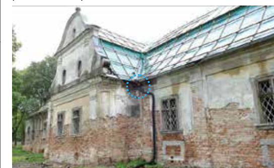
nevhodne odvedená dažďová voda
