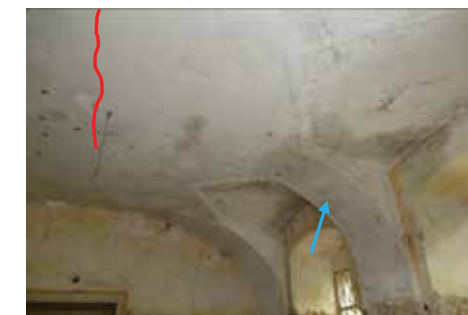
premokrená klenba trhliny
