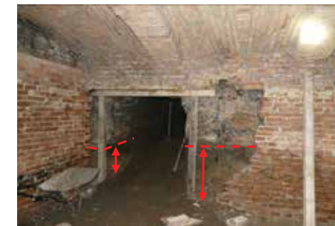
podkopaná základová škára oplenie interiérových líc
