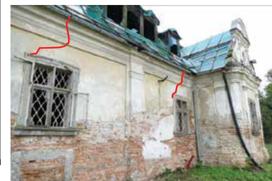
deformácia muriva nevhodne odvedená dažďová voda
