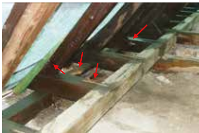
hubou a hnilobou poškodené prvky
