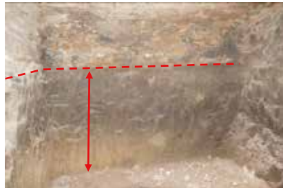
podkopaná základová škára
