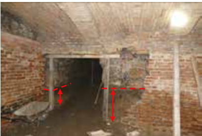
podkopaná základová škára opletovanie interiérových líc múrov
