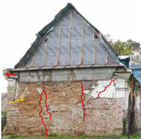
deformácia štítu severného krídla
