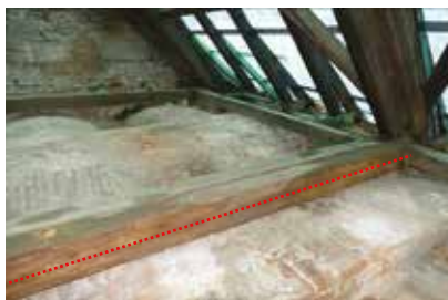
Vázný trám poškodený fúzačom krovovým
