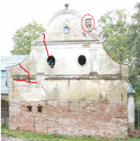
deformácia štítu južného krídla poškodený komín
