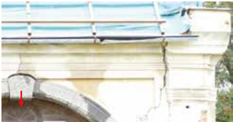
vplyvom statickej poruchy posunutý klenák trhlina v murive
