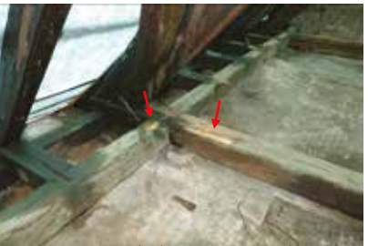
prvky poškodené fúzačom krovovým
