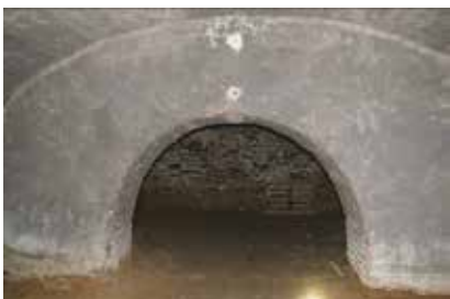
cementová škrupina - vytlačenie vzliňajúcej vlhkosti do nadzemných častí muriva
