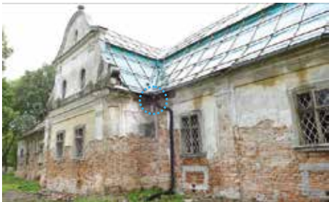
nevhodne odvedená dažďová voda
