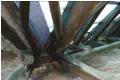
poškodené prvky východného krídla
