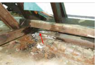
hubou poškodené prvky
