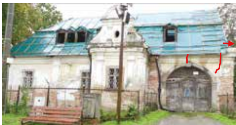
deformácia štítu severného krídla nevhodne zabudované vikiere
