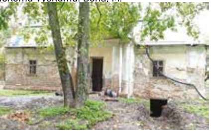
vstup do pivníc podkopané základy
