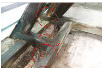
poškodené prvky pod vikierom
