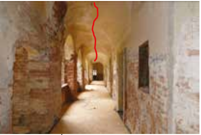
trhliny v arkádovej chodbe
