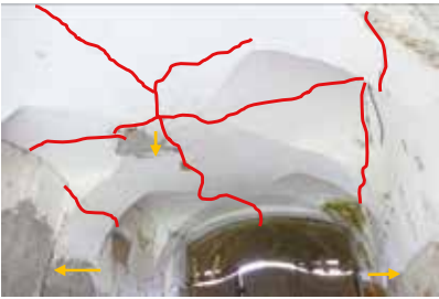
havarijný stav prejazdu v severnom krídle
