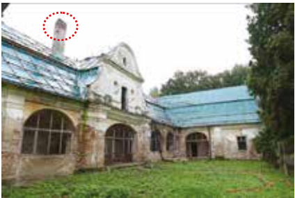
zatekaním zrážkovej vody cez poškodenú krytinu
