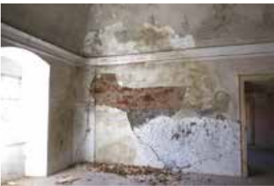
nevhodná úprava stien - zadržiavanie vlhkosti
