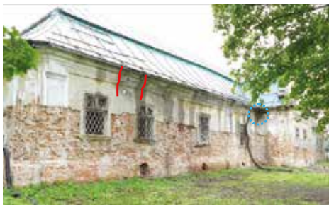
deformácia muriva nevhodne odvedená dažďová voda
