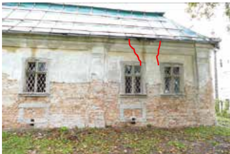
deformácia muriva zaslepenie vetracích otvorov pivníc
