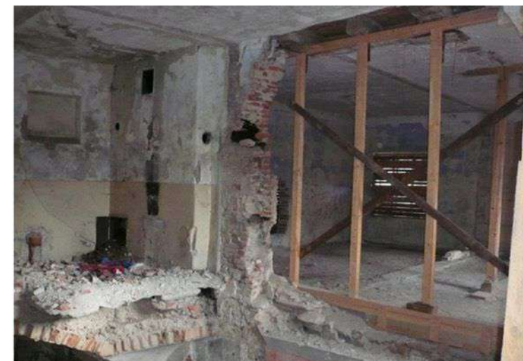
Chýbajúca nosná stena, vystužená drevenou konštrukciou
