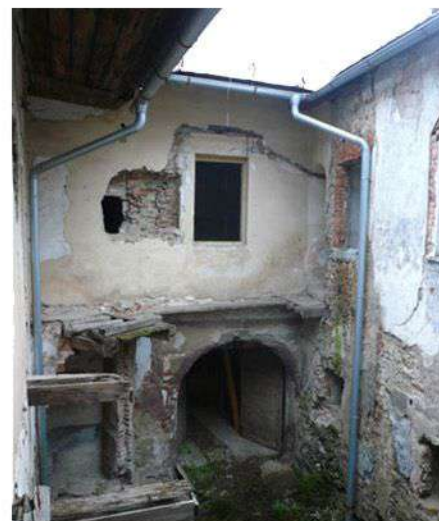
Chýbajúce časti v muríve a viditeľné vedenie rozvodov
