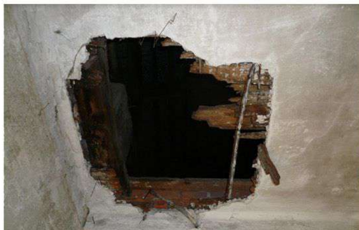
Diera v strope a viditeľné opotrebovanie drevených stropných konštrukcií.
