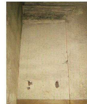
Veľmi zle riešenie z murovania dverného otvoru
