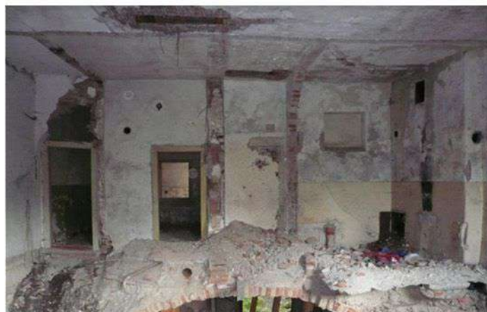
Prepadnutý strop a klenba, dnes čiastočne podložená drevenou podpornou konštrukciou.
