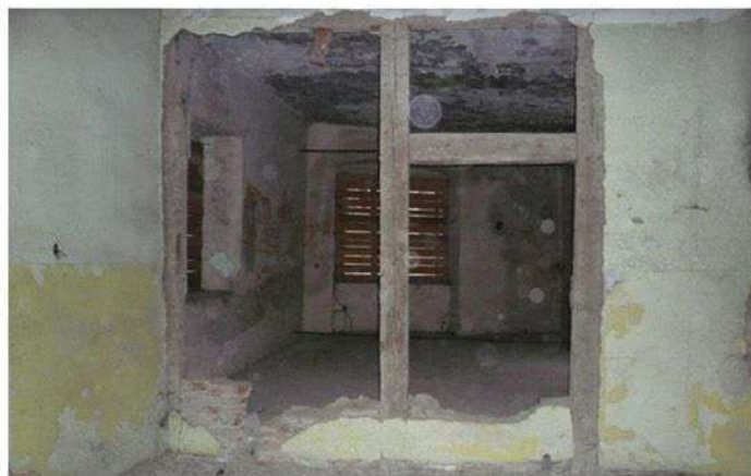
Poškodenie muríva, viditeľná hrádzená konštrukcia
