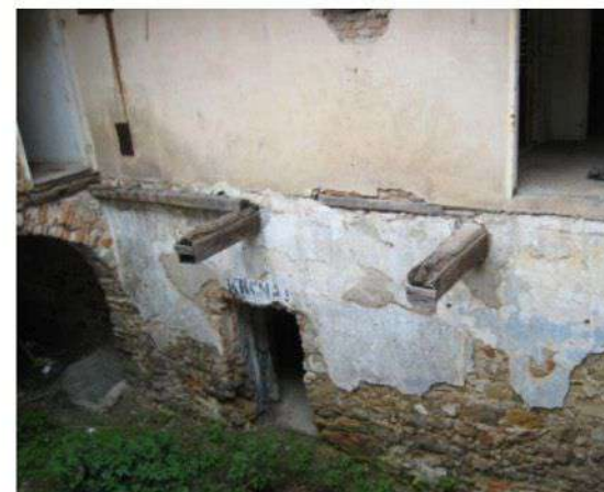
Viditeľné opotrebovanie omietok a drevených konštrukcií
