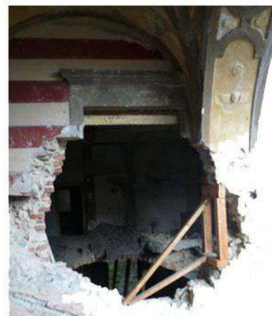
Poškodenie muríva a chýajúce kamenné okenné člásky
